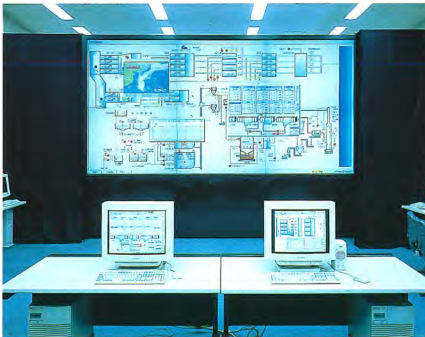
大画面システムによるプラント監視
