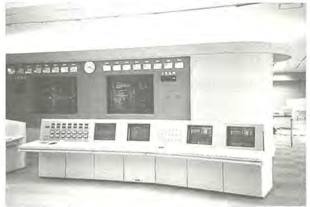
中部電力(株)川越火力発電所4号系列中央制御室
