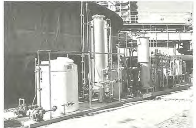
実証試験プラント外観
