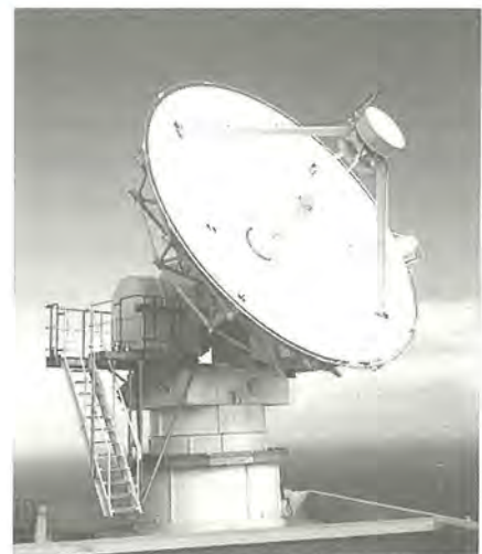
C 帯高精度追尾レーダ・Ku 帯テレメトリ共用アンテナ
