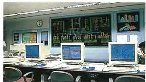
中央防災センター総合操作盤
