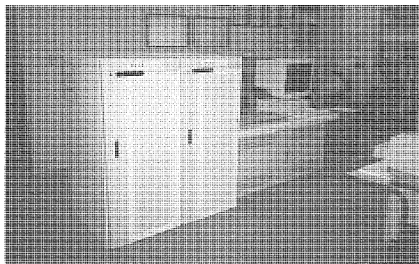
図5. 監視制御・運転支援計算機装置(メインサーバ)
