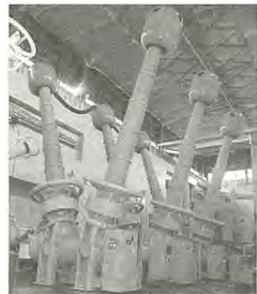
東京電力(株)新所沢変電所納め550kV, 63kA 1点切りGCB
