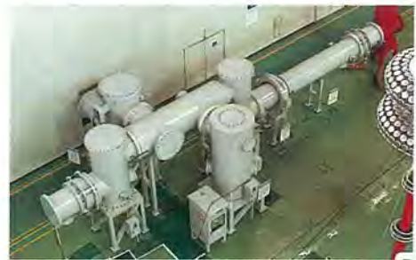
直流GIS(長期性能確認試験用)
