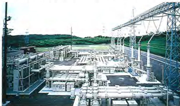
南相馬変電所500kVヤード全景
