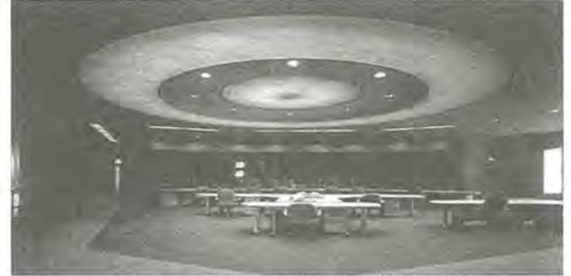
東京電力(株)南横浜火力1号機の中央操作室
