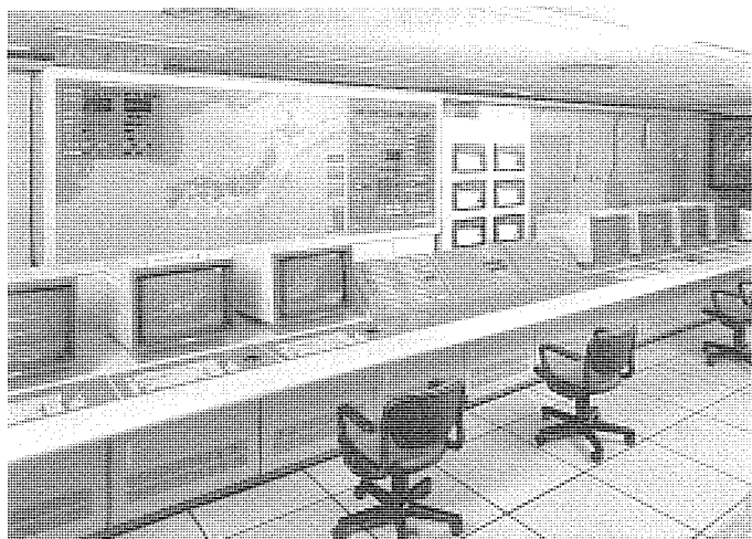
図3. 設置状況 (現業室)
