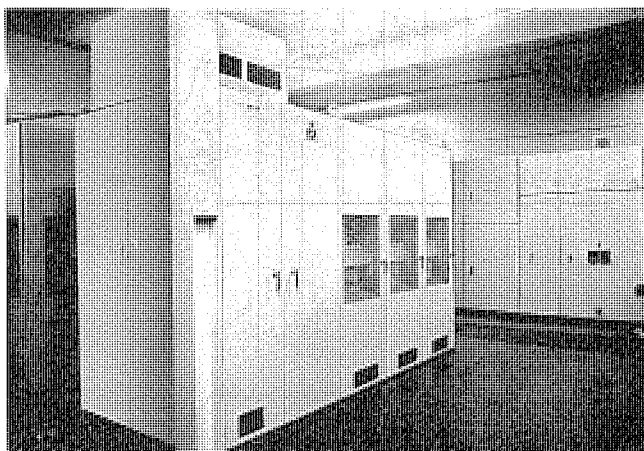
図4. 外観(現地据付状態)
