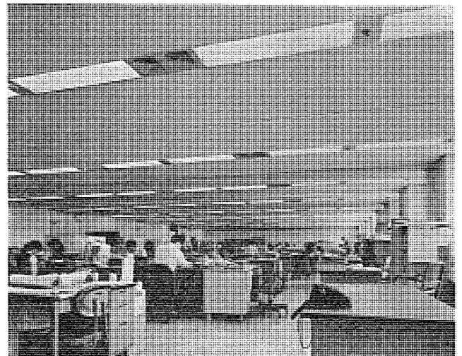
図 8. システム天井方式の施設例
