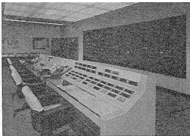
東京電力(株)納め厚川制御室
