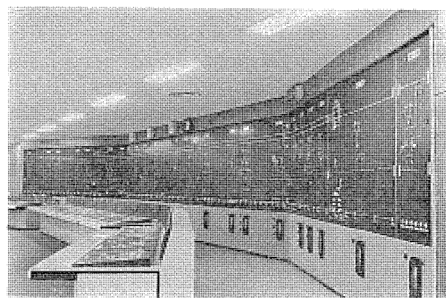
中央電気指令所全景
