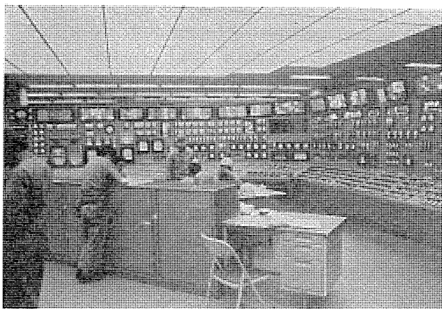
試運転中の関西電力(株)大飯発電所中央制御室
