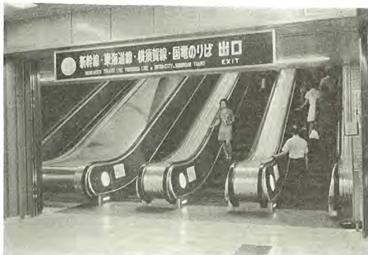
図 1. 東京駅に設置された エスカレータ
