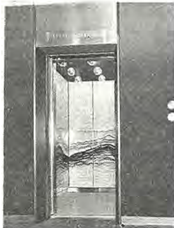
図 13. 岡山国際ホテル納めエレベータかご室及び乗場 Elevator cage and entrance for Okayama Kokusai Hotel.
