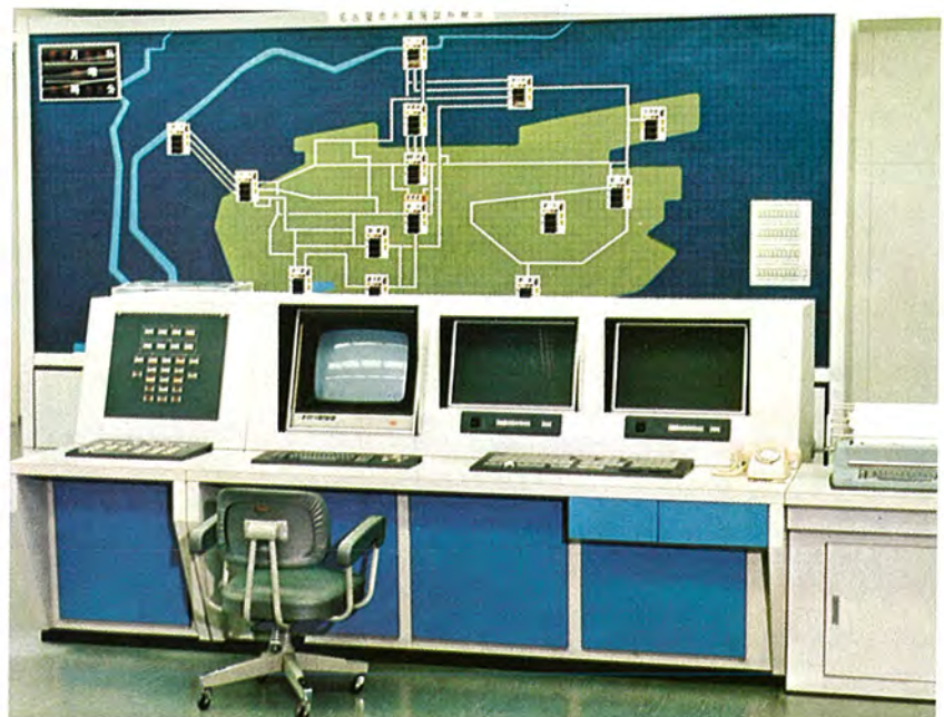
名古屋市水道局中央管理室(本文の4-1.7参照)
