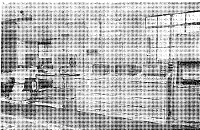
図 6. 関西電力(株)伊丹給電所向け自動処理装置 Automatic processing equipment for Itami area control center, Kansai Electric Power Co.
