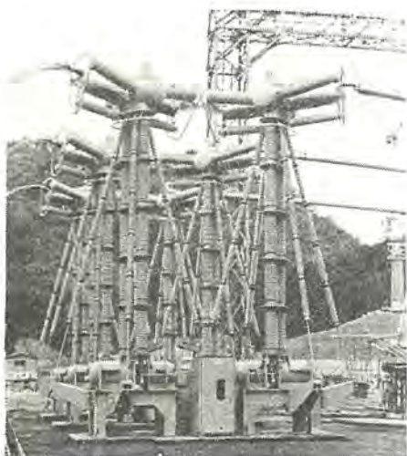
図 22. 500-SFH-50 形 ガス シャ断器 500 kV 4,000 A 50 kA 2 Hz Type 500-SFH-50 gas circuit breaker.
