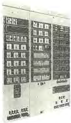
図12. 関西電力(株)納め 超々高圧系統用 純粋位相比較継電装置(フィールドテスト用試作機)
