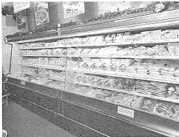
図 3.1 二段圧縮式冷凍システムによって冷却されている低温多段オープンショーケース Low temperature display case with multideck using compound refrigerating system.
