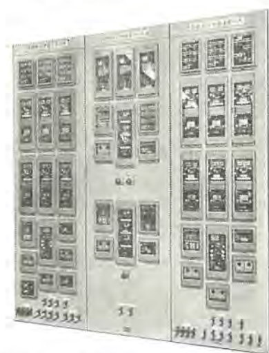
(主保護中央面, 後備保護甲左1面, 後備保護乙右1面) 図 2.3 275 kV 各相表示線保護継電装置 275 kV pilot wire relaying scheme
