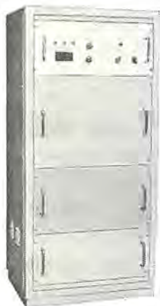
図 3.5 OP-3 制御盤 OP-3 control panel.
