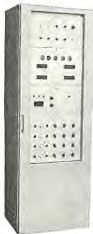
図 3.4 OP-1 制御盤 OP-1 control panel.
