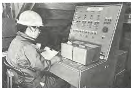
図 3.3 遠隔集中操作盤 (C 2 方式) Centralized remote control console desk.
