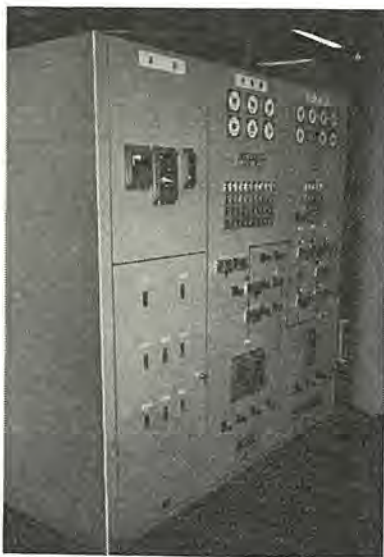
図 5.5 主配電盤 Main switchboard.
