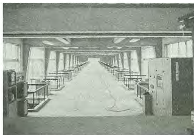
図 2.5 ろ過池ローカルコントローラ盤設置状況 View of the local controller for filter.
