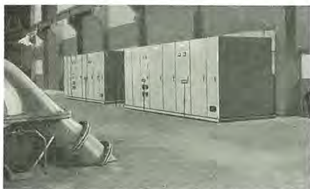
図 3.5 阪神水道企業団 (大道) 1,200 kW 静止セルビウス装置 Static Scherbius apparatus for 1,200 kW pump motor.
