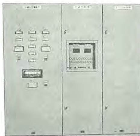
図 2.4 ろ過池ローカルコントローラ盤 Local controller panel for filter.
