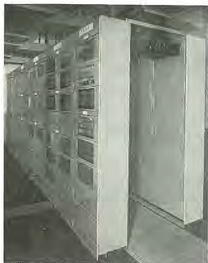
図 4.3 遠方監視制御継電器盤 Relay panel (control station).
