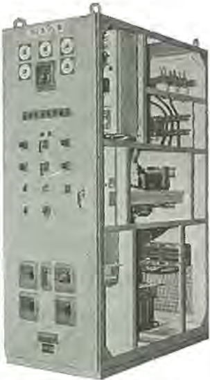
高圧ディーゼル発電機盤
