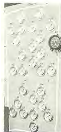
図 3.4 圧力計パネル Pressure gage panel.
