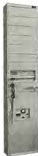
図 5.6(a) 傍受局装置外観 (鎌倉、谷ヶ原) Fig. 5.6(a) Bay assembly of substation.
