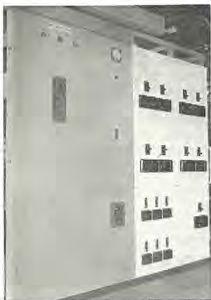
図 6.1 トライパックシヤ断器を組み込んだ配電盤 (盤の表面からヒューズユニットを取りはずすことができる)
