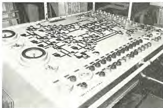
図 4.3 前処理工場用コントロールデスク Fig. 4.3 Control desk for pretreating factory. (Jet proof type)
