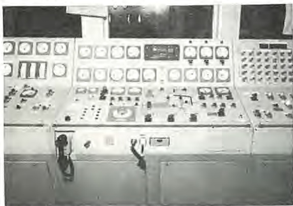
図 5.4 エンジンルームコントロールコンソール (タービンパネル) Fig. 5.4 Turbine control panel in the engine room.
