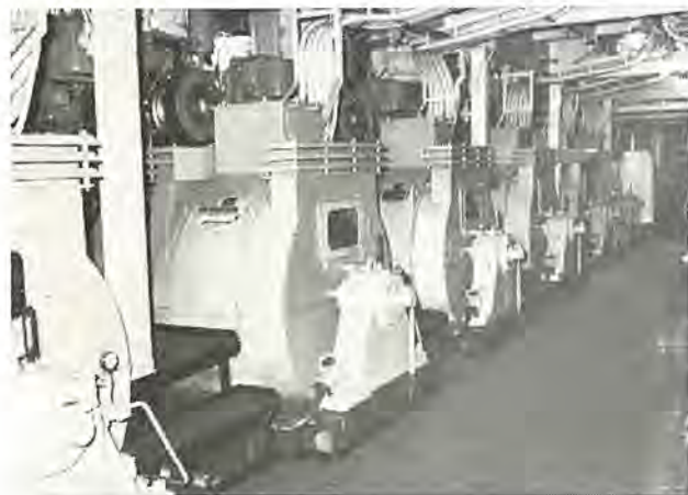
図 2.1 船内に装備された 6×650 kVA 主発電機 Fig. 2.1 6-650 kVA main ship service generators installed on the fish factory ship.
