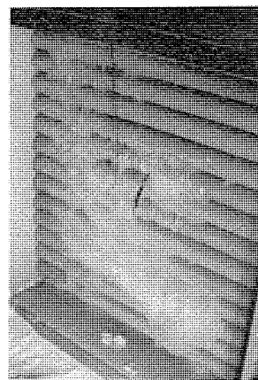
図2 冷却器の目づまり状況の一例
