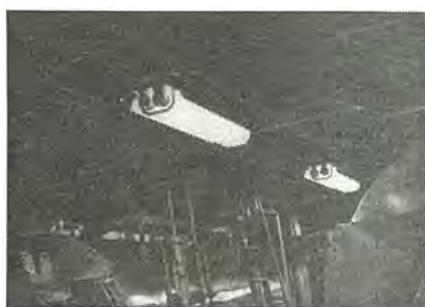
⑦-b 明治生命館(大阪)ボイラ室 FWE-402 14 台 150 lx
