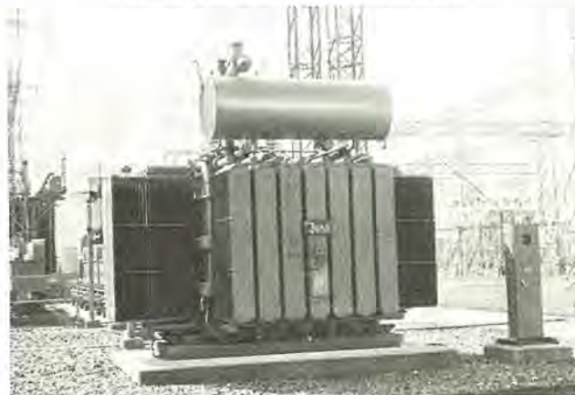
図 2-16 関西電力伊丹変電所納め 20MVA 77kV 分路 リアクトル 20 MVA shunt reactor for Kitaōsaka substation of the Kansai Electric Power Co.
