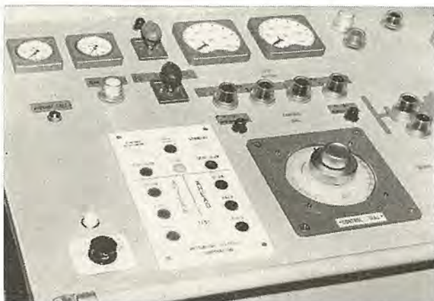
図 5-16 主機操縦盤 Main engine control console.
