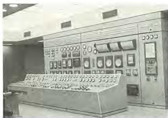
図 1-10 中国電力岩国火力発電所1号機用 BTG 中央制御盤 BTG central control board for Iwakuni thermal power station No. 1, Chugoku Electric Power Co.
