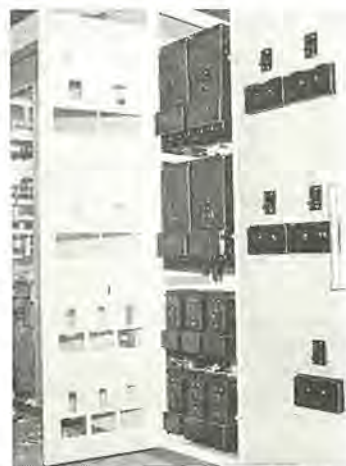
図 5-4 トライバックブレーカを収納した給電盤 Marine feeder panel housing TRI-PAC breaker.
