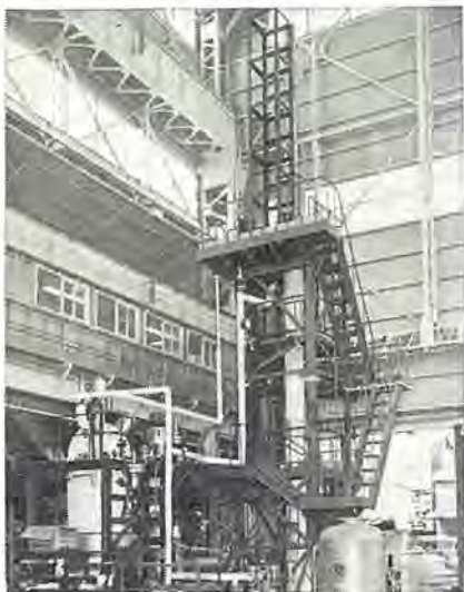
図 19-1 試験設備に据え付けられた磁気ジャック 形制御棒駆動装置 Magnetic jack control rod drive mechanism installed in the test facilities.
