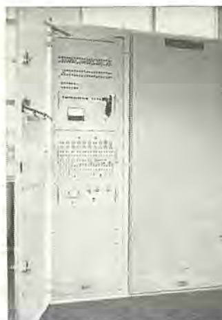
図 14-22 電解ソウ電圧監視装置 Electrolytic cell monitor.
