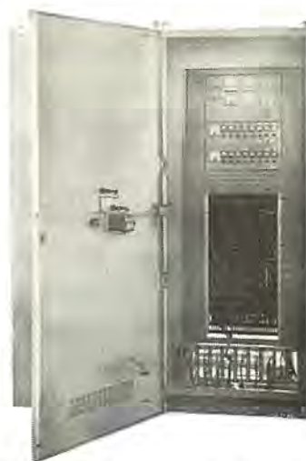
図 4-2 三菱レイノルズプロダック 制御盤 Control panel of PRODAC supplied to Mitsubishi Reynolds Co.
