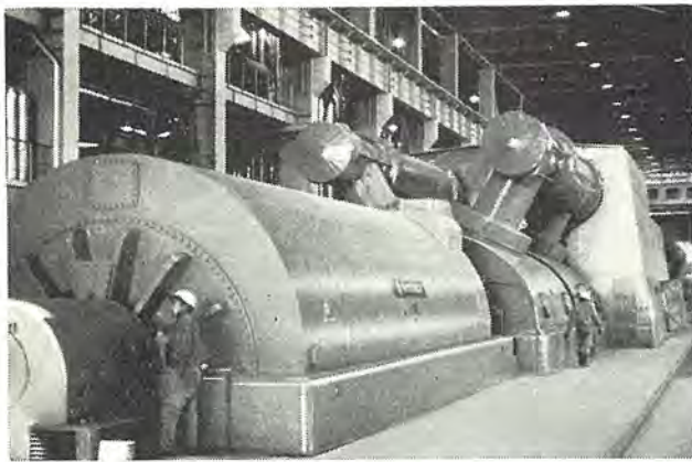
図 8-3 姫路第二火力 325 MW T/G 試運転 現地試験中 325 MW turbo-generator for Kansai Electric Power under test.
