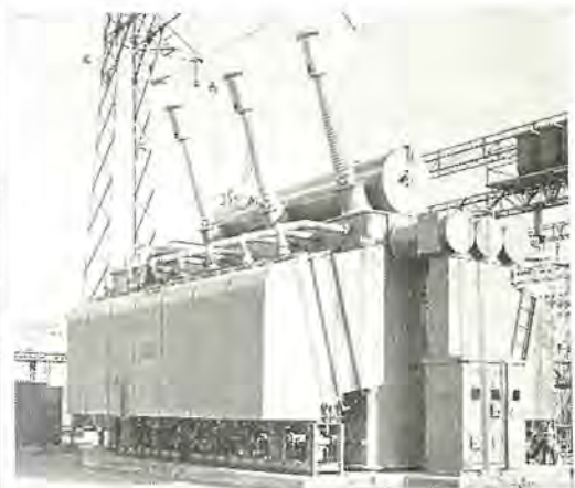
図 2-2 関西電力 伊丹変電所納め 345MVA 低騒音形負荷時 タップ 切換変圧器 345MVA special three phase low noise level on-load tapchanging transformer for Itami substation, Kansai Electric Power Co.
