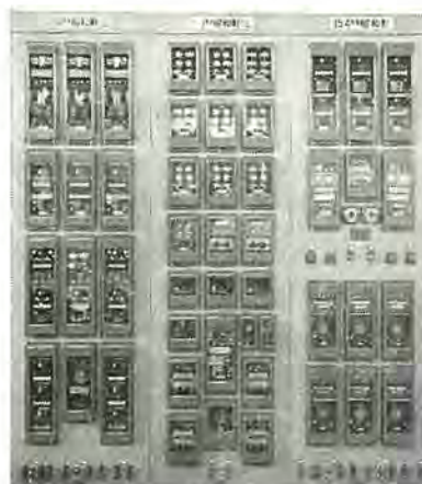
図 2-72 PC-337 形搬送保護継電装置 (中部電力 昭和町 s/s 納入) Type PC-337 carrier relaying scheme.
