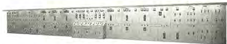
図 5-3 主配電盤 650kVA×6 Main switch board of ACG 650kVA×6 sets.
