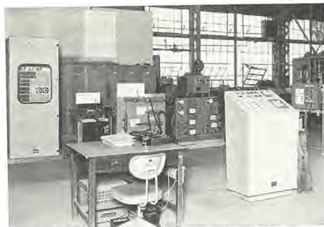
図 5-20 ディーゼルエンジンのリモートコントロール装置 Remote control system of main diesel engine.
