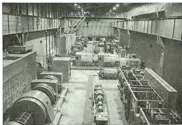
図 8-11 コールドミル 電 気 室 View fo cold mill plant.
