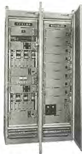
図 3-3 日新製鋼納め粗圧延機用速度調整盤 Automatic speed control cubicle for roughing mill motor for the Nisshin Seiko Co.
