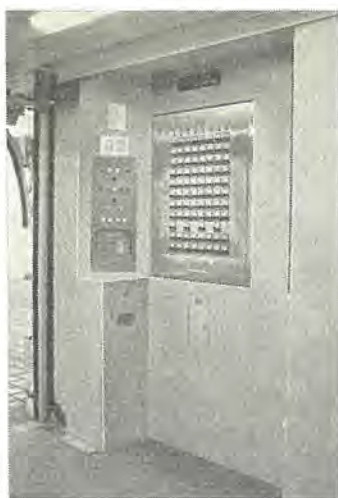
図 6.1 大阪市安土町駐車場 カゴ 操作盤 Fig. 6.1 Cage operating panel of parking place, Azuchi-cho Ōsaka.
