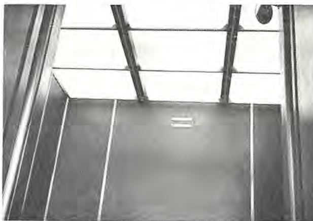
図 4.1 カゴ室天井照明 Fig. 4.1 Lighting system of cage.
