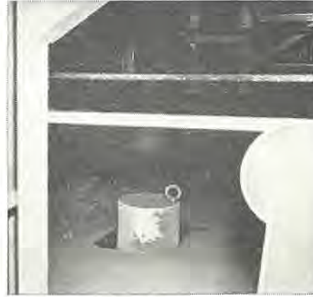
図 4.3 原料通過検出装置の線源取付状況
