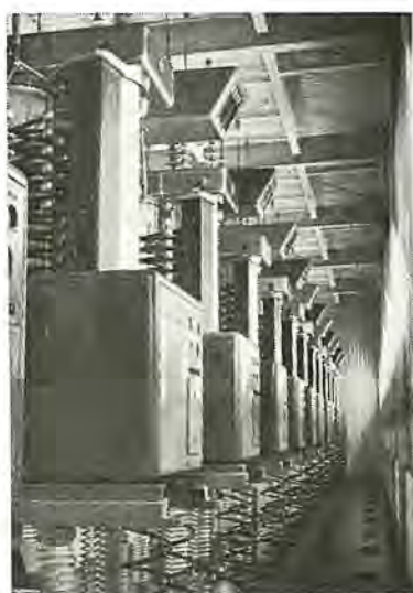
図 3.1 バルブ Fig. 3.1 Valves.
