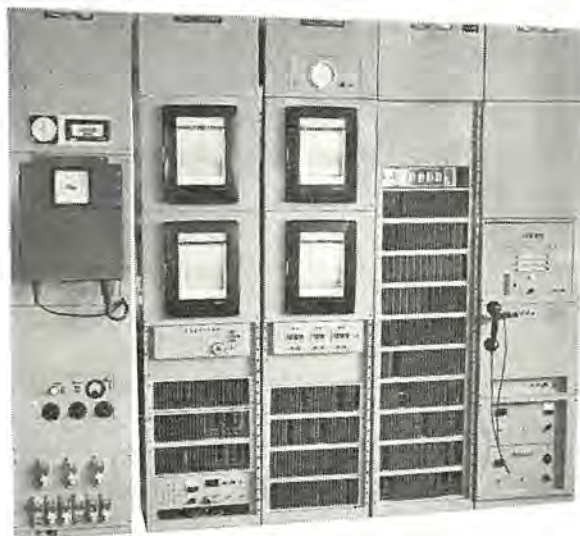
図 2.1 気象 テレメータ 富士山局装置 Fig. 2.1 Telemeter equipment of Mt. Fuji station.
