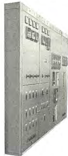
図 8.5 補助盤 Fig. 8.5 Auxiliary panel.
