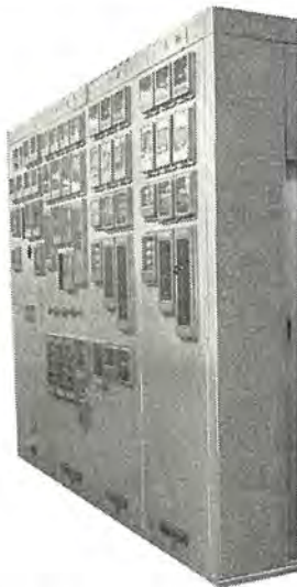
図 8.3 保護継電器盤 Fig. 8.3 Protection relay panel.
