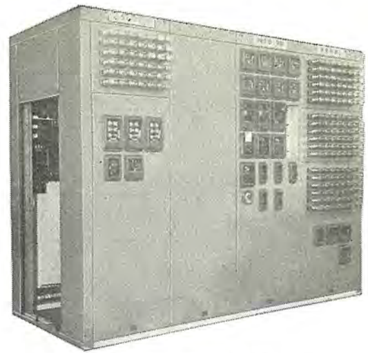
図 8.4 自動制御盤 Fig. 8.4 Automatic control panel.
