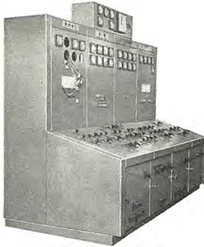
図 8.2 主配電盤 Fig. 8.2 Main switch board.
