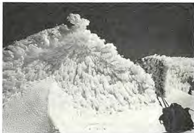
図 2.1 (b) 富士山頂浅間神社社務所 Fig. 2.1 (b) Rime ice covering the roof of shrine on the top of Mt. Fuji.
