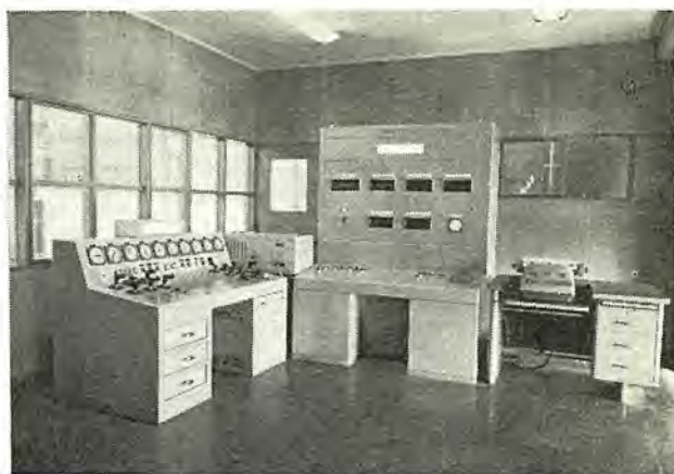
図 3.4 低落差水車性能試験装置操作盤および計測盤 Fig. 3.4 Central operation room.
