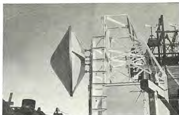
図 3.1 富士山局リレー空中線 Fig. 3.1 Microwave relay antenna on the top of Mt. Fuji.
