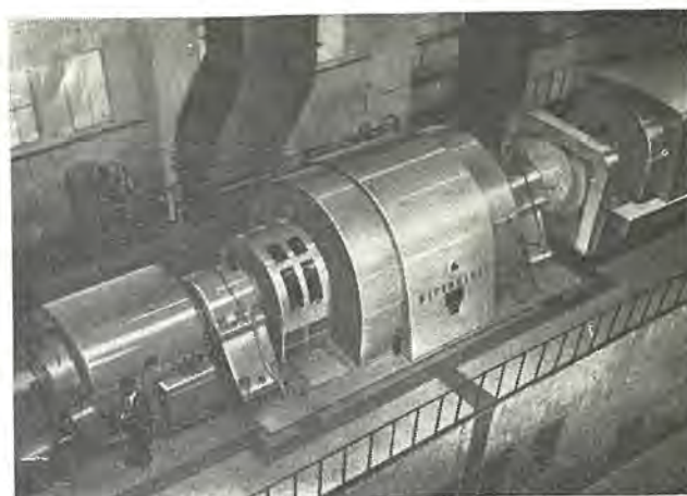
図 2.11 遷音速風洞主送風機用 22,500 kW 電動機 Fig. 2.11 Transonic wind tunnel drive equipment.
