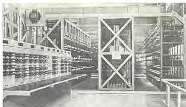
図 1.42 模 擬 送 電 線 設 備
