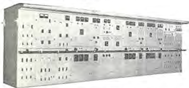
図 4.13 強制同期投入装置を組み込んだ主配電盤 (400 kVA 400 V 50 c/s 3 台用)
