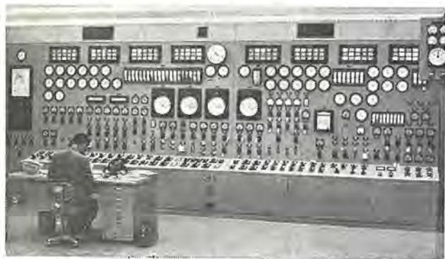
図 1.30 関西電力姫路第二発電所 ボイラ・タービン中央制御室 Fig. 1.30 Central control board.
