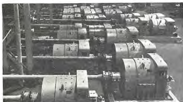
図 2.7 6 スタンド 連続式冷間圧延機用電動機 Fig. 2.7 DC motors driving 6-stand tandem cold reduction steel strip mill.
