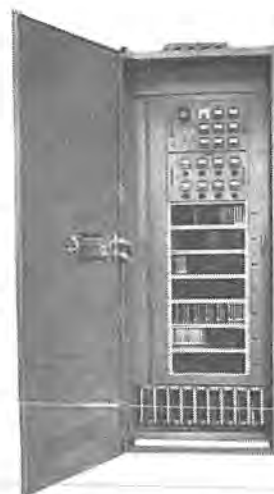
図 2.9 ロール 圧下自動制御用 プロダック キュービクル Fig. 2.9 "PRODAC" cubicle for automatic screw down control.
