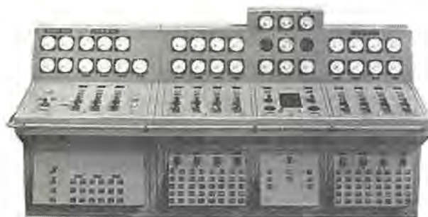
図 4.15 発電機および推進主機関総括制御盤 (日本国有鉄道青函連絡船向け)
