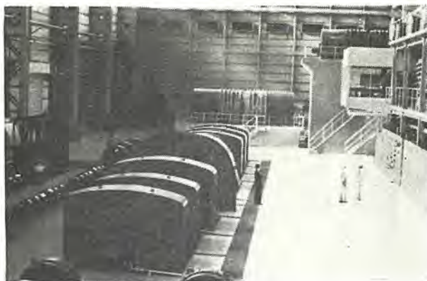
図 2.1 電気室 Fig. 2.1 Motor room.
