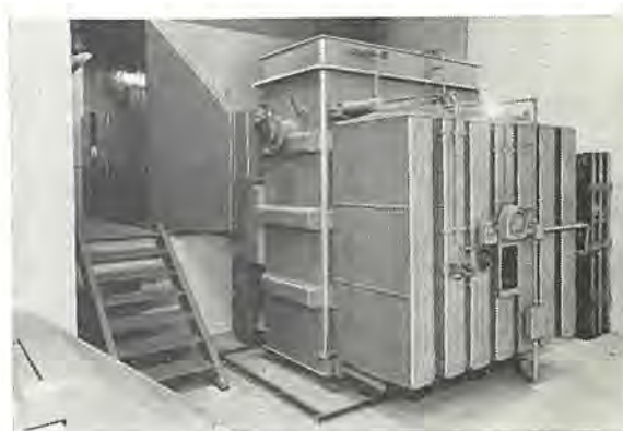
図 1.28 ビル用 60 kV 屋内 キュービクル 主変圧器の キュービクル 組込み状態
