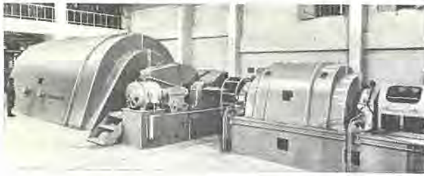
図 1.2 3,430 MVA 15 kV 短絡発電機 Fig. 1.2 Short-circuit test AC generator.
