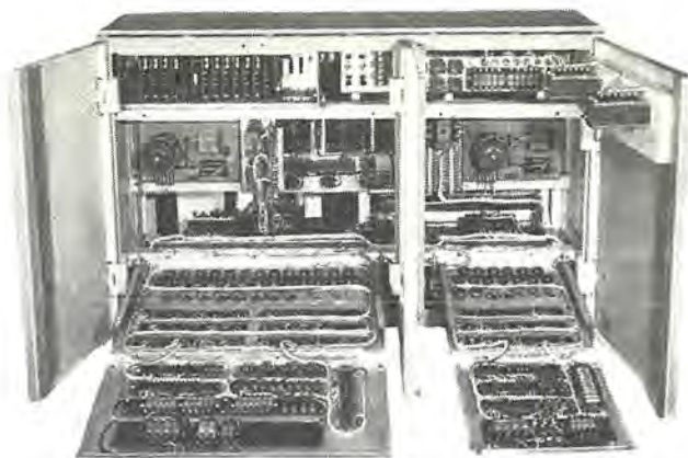
図 4.31 タービンリモートコントロール用 リレーパネルの開放状態
