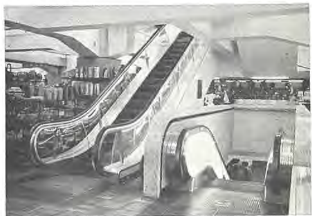
図 3.2 阪急百貨店 1200 DTT 形 エスカレータ Fig. 3.2 Escalators for Hankyu department store.
