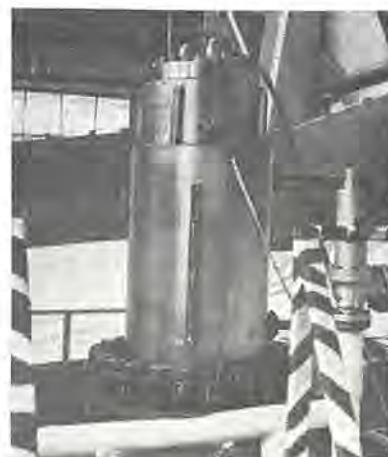
図 2.28 350 kVA キャンドモータポンプ
