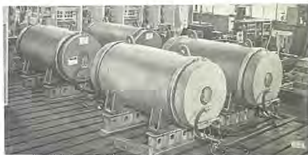
図 2.63 4 x 300 kVA 3,000 c/s 高周波発電機 Fig. 2.63 High frequency generators.
