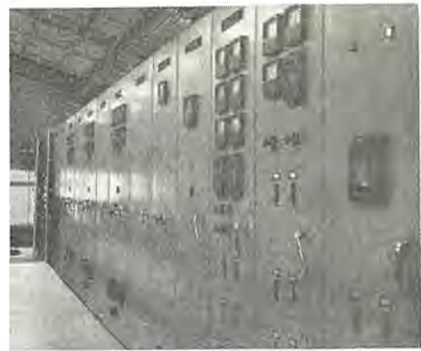
図 1.8 ラオス 政府向け 3×1,250 kVA D/G 用配電盤 (現地据付状態を示す)
