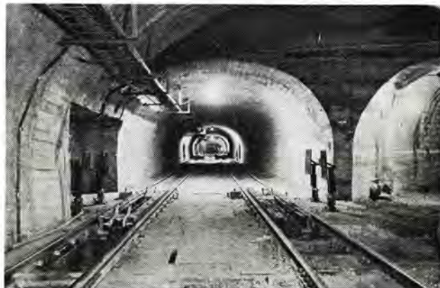
図 6.2 坑底操車線設備 クリーパ
