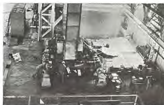
連続亜鉛メッキタンク (調整中)
