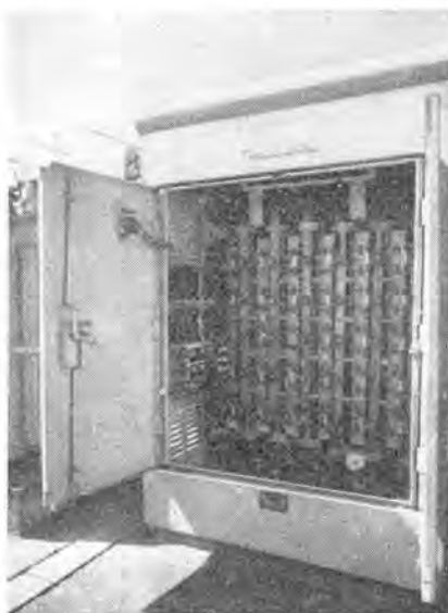
図 4.4 屋外変電所 (三菱化成納) Fig. 4.4 Out-door type silicon rectifier.
