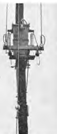
装柱された CSP 変圧器
