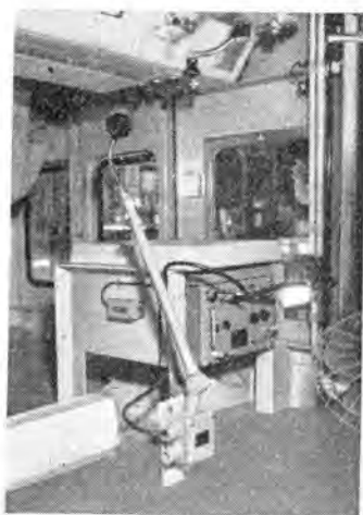
運転室の 誘導無線装置
