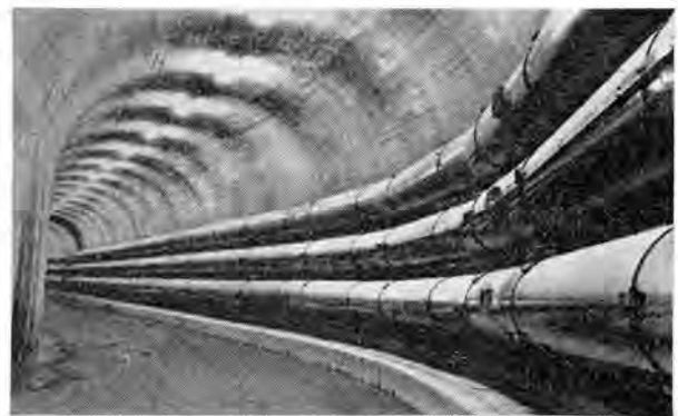
図 2.1 KB 形離相母線 関西電力株式会社読書第二発電所納め
