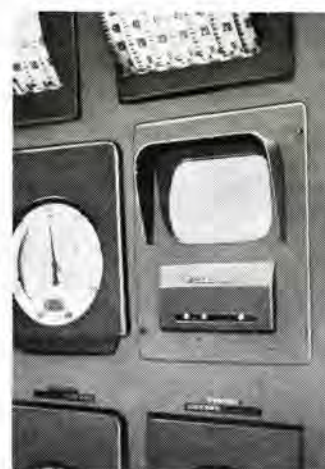
図 3.1 ボイラ制御盤に装着された制御監視機 中国電力小野田火力発電所（受像画面は重油点火時を示す）
