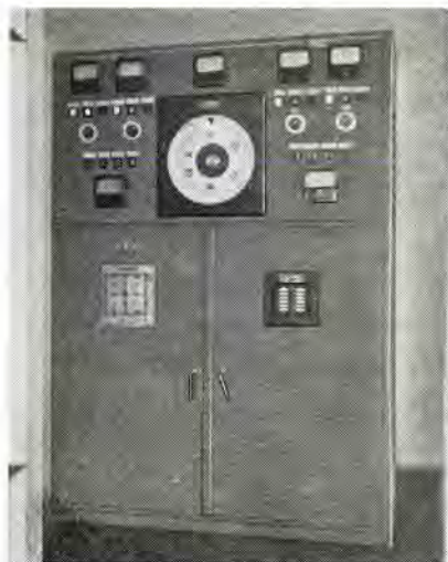
図 5.4 鈴与倉庫の中央操作盤 Fig. 5.4 Central operation panel.
