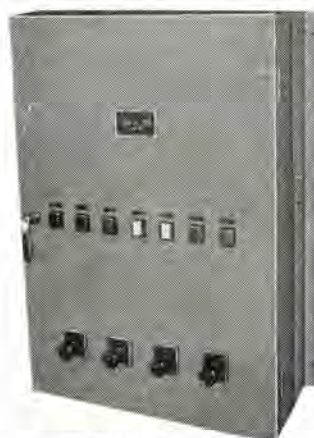
図 3.18 制御盤 Fig. 3.18 Control box.
