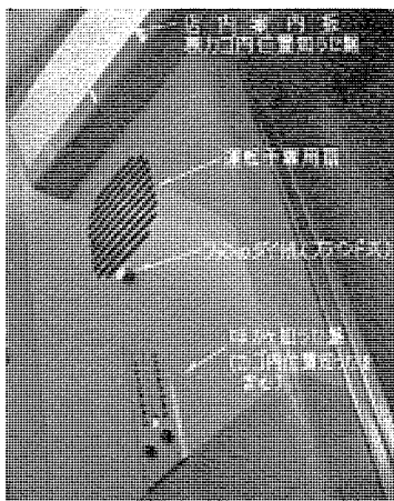
2 図 カゴ室照明 吊天井間接照明 (神戸そごう納) Fig. 2. Car lighting.
