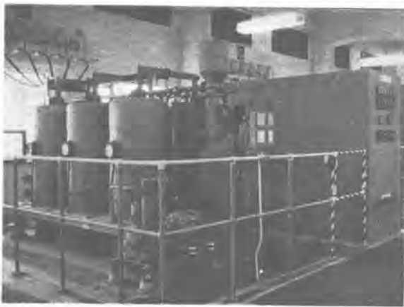
1 図 3,000 kW 1,500 V 6 タンク方式 風冷式イグナイトロン整流器
