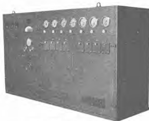
18 図 水車制御のキャビネット
