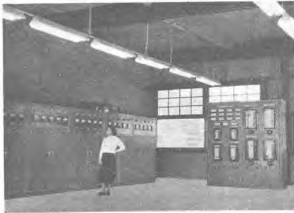
7 図 D 系統低圧電動機盤
