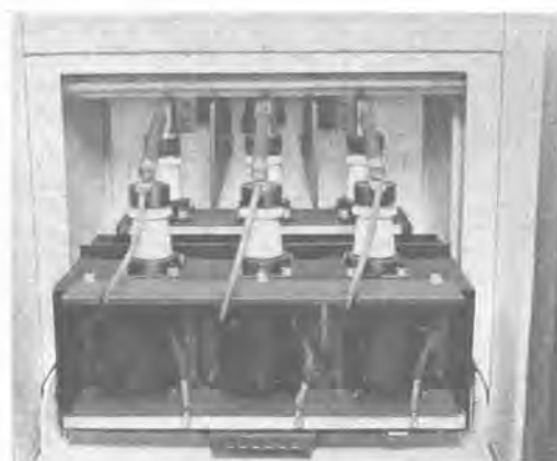
15 図 計器用変成器室 Fig. 15. Chamber of potential transformer.
