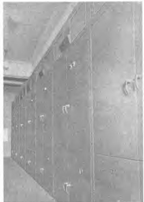
東京電力日比谷変電所納入 20kV キュービクル外観
