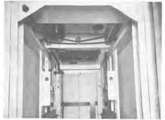
6 図 WB 型遮断器室内部 Fig. 6. Type WB breakers chamber.
