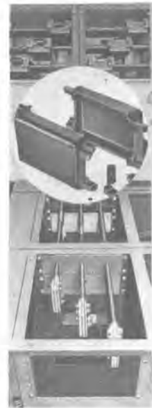
12 図 母線室 Fig. 12. Bus chamber.
