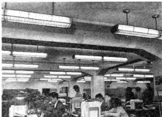
9 図 事務所照明 (東京ビル当社事務所)
