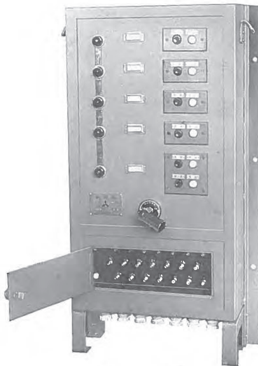
レンプラント 制御装置
