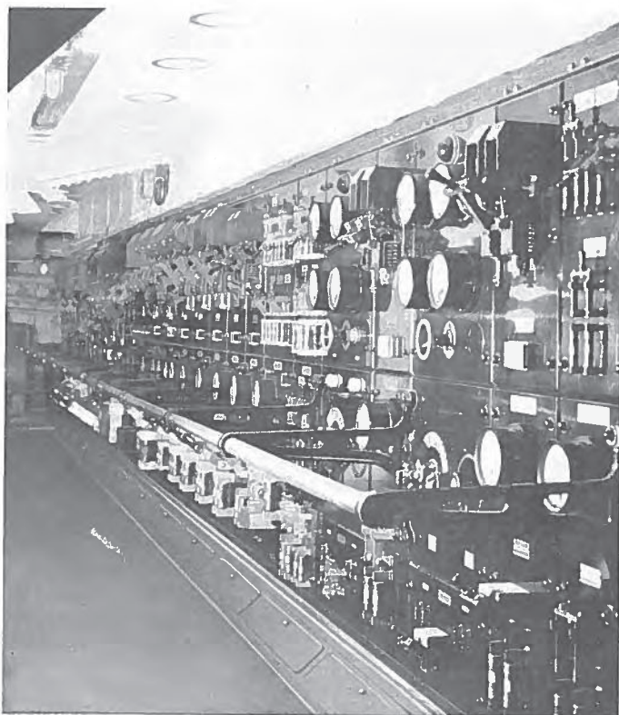
600 kW 用 主 配 電 盤
