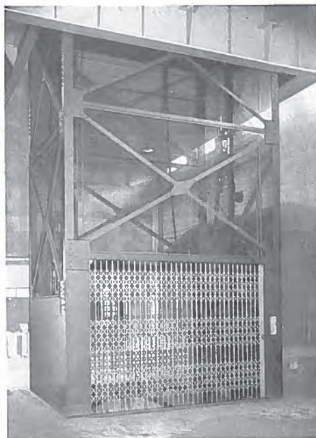
貨物用 エレベータ (鐵塔付) 容量 2,000 斤
