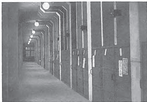
第1圖 コンパートメント室
