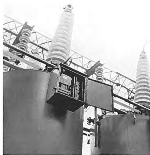
第 1 圖 161 kV 油入遮斷器に取付けた分壓器
