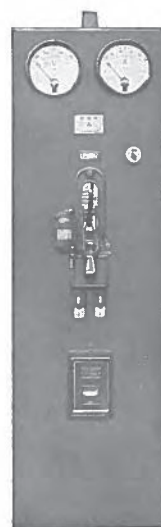
第 13 圖 H S型配電盤
