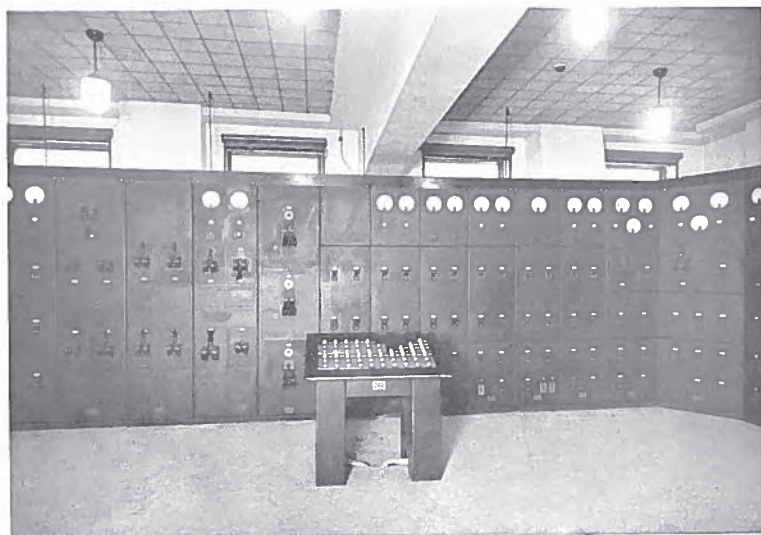
第 3 圖 低圧配電盤の一部(中央は制御機)
