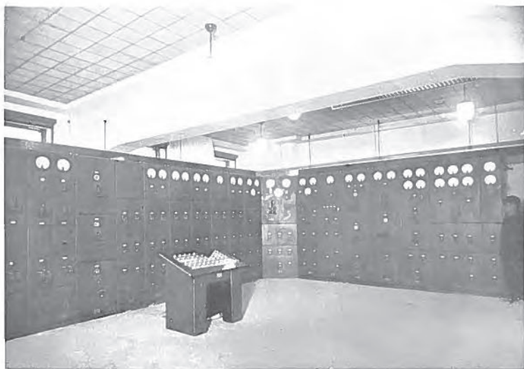
第4圖 低壓配電盤
