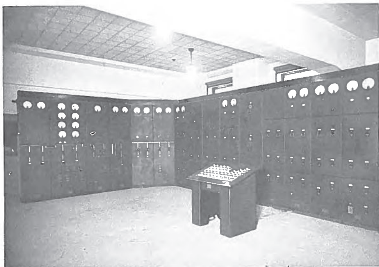
第 2 圖 高圧配電盤及低圧盤の一部(中央は制御機)
