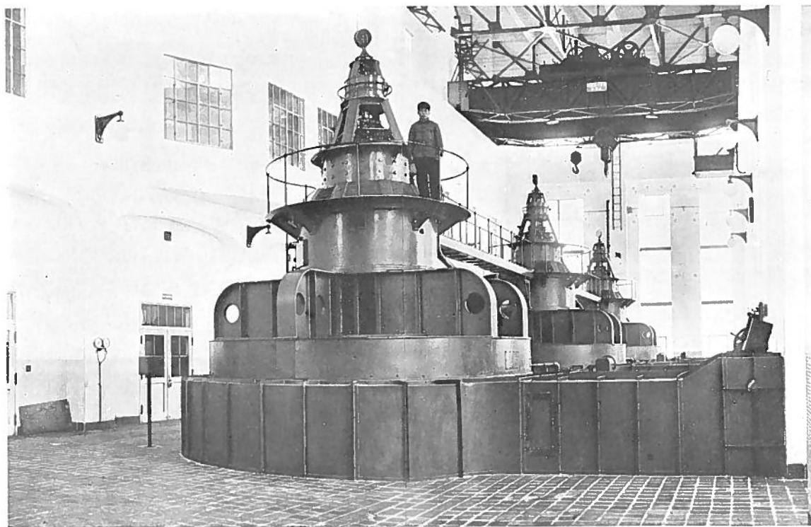
第 3 圖 16,250 kVA 水 車 發 電 機
