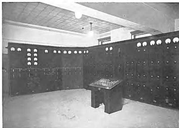
JOAK 會館納入ビルディング用配電盤 Switchboard "JOAK" Building
