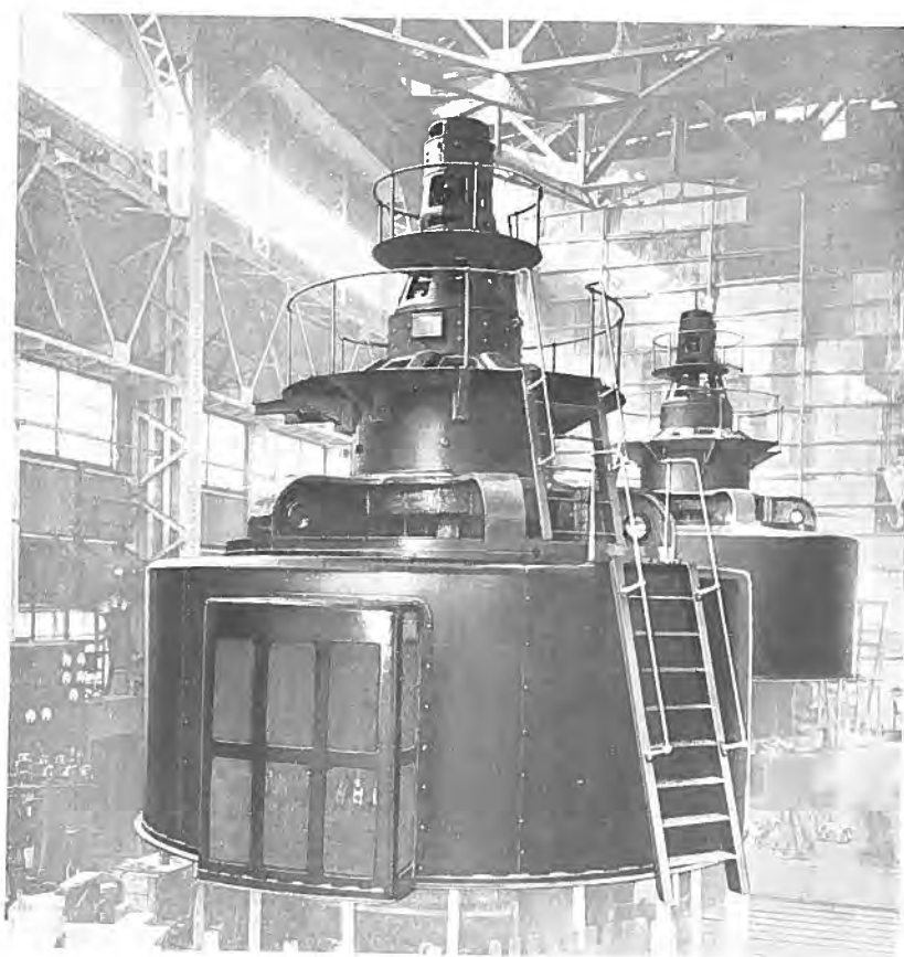
工場組立中の発電機
