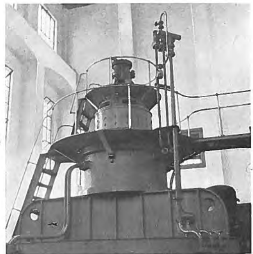
第9圖 4,200 kVA 發電機 (盛岡電燈) 點檢用プラットフォーム・梯子並に滑油配油弁を示す
