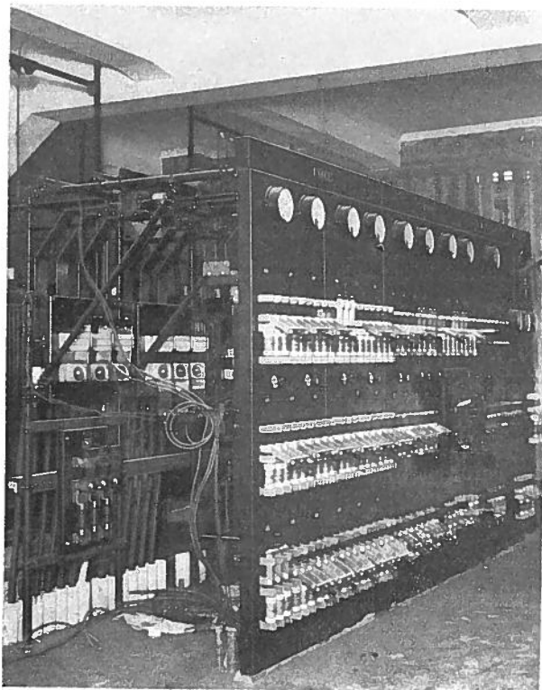
第 5 圖 所内低壓饋電盤
