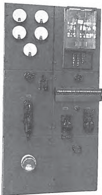
第4圖 三菱高周波電気爐用 発電機並に調整器盤
