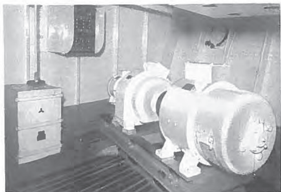
第 43 圖 50馬力絞盤機用誘導電動發電機及界磁加減抵抗器
