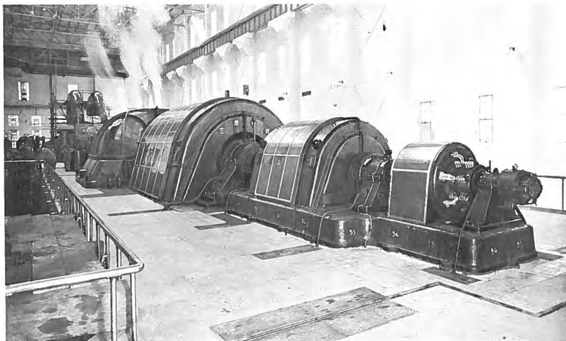
第 1 圖 東京電燈株式會社鶴見發電所 62,500 kVA 1,500 R.P.M. 三菱タービン發電機
