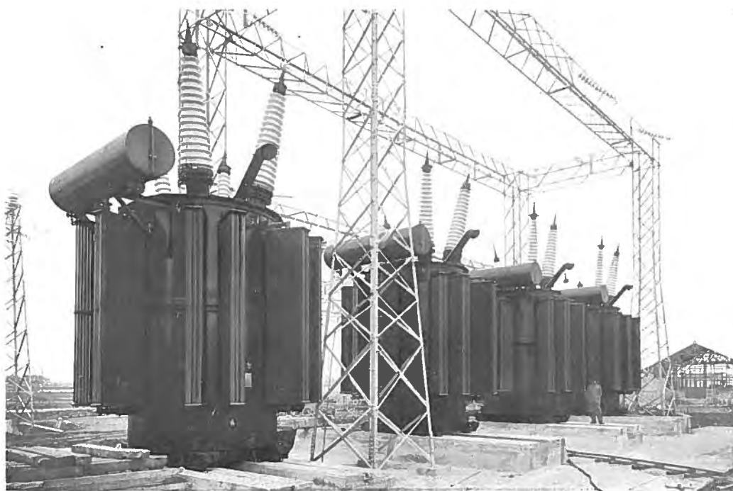
第 1 圖 大同電力株式會社 松岡變電所納 10,000 kVA 單相三捲變壓器
