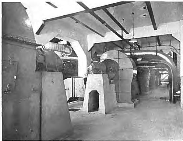
第3圖 強壓通風機用電動機
