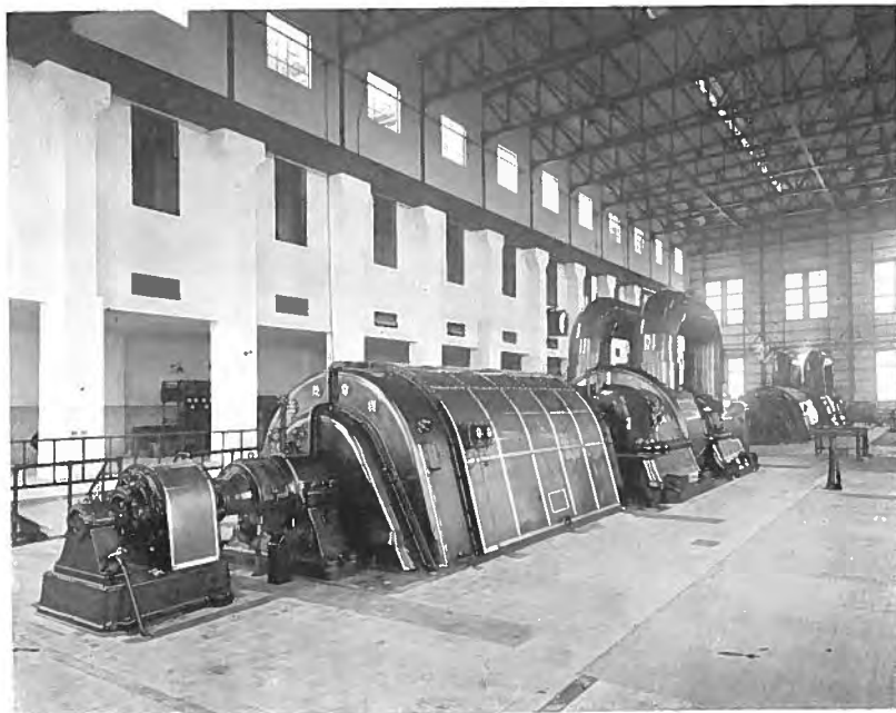
第 1 圖 主 發 電 機
