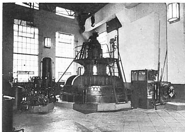
第 4 圖 王泊發電所發電機室
