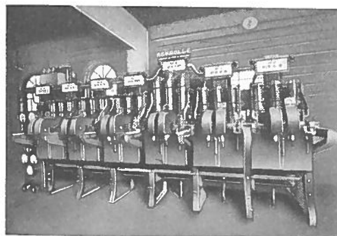
第 8 圖 神戸市電気局相生橋配電所 11,000V、C 3 型配電盤 7 面
